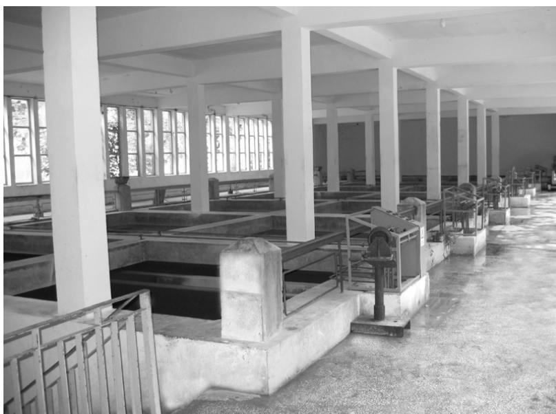
Fig. 3. Sala filtrelor la stația de tratare a apei de la Săsciori (Sebeșel)
